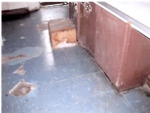
Piso flexit en mal estado
