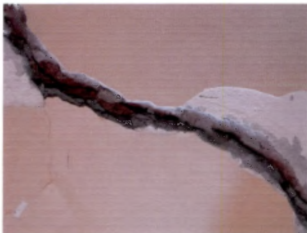
Grieta de importancia
