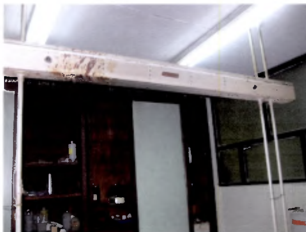
Lámpara en mal estado
