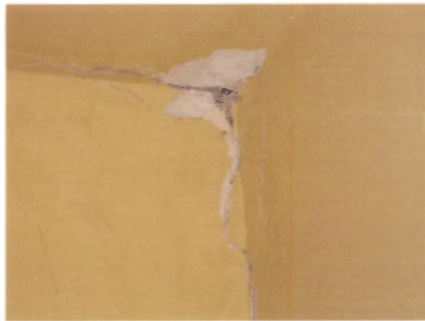
Daños en la muralla
