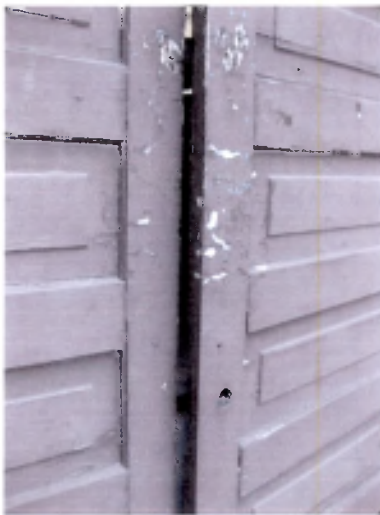
Segunda puerta de acceso sin seguro
