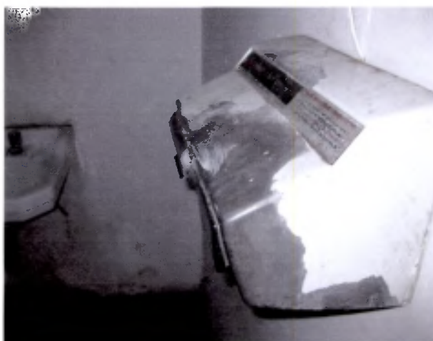
Equipamiento en mal estado
