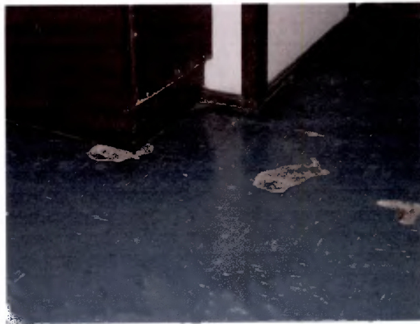
Piso flexit en mal estado
