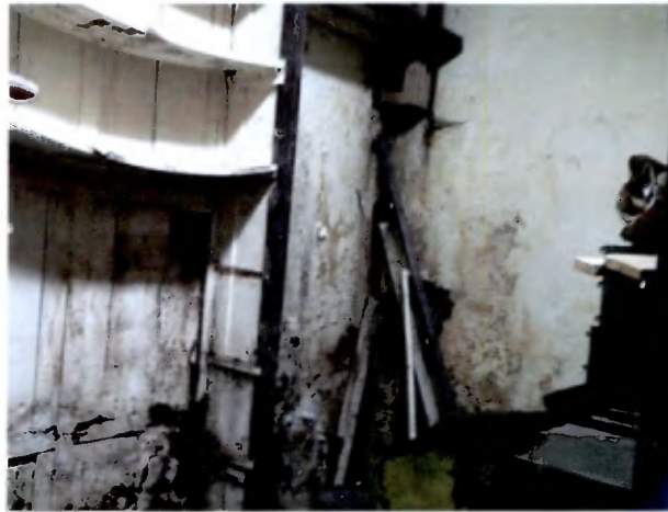
Dependencias afectadas con aguas servidas
