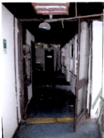
Ducha para eliminar residuos en mal estado
