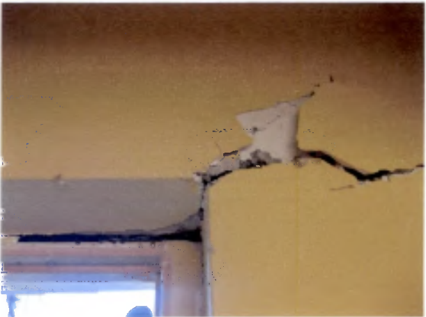
Marco de puerta dañado
