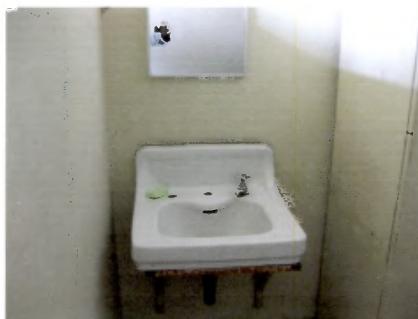
Cuarto de baño sin accesorios
