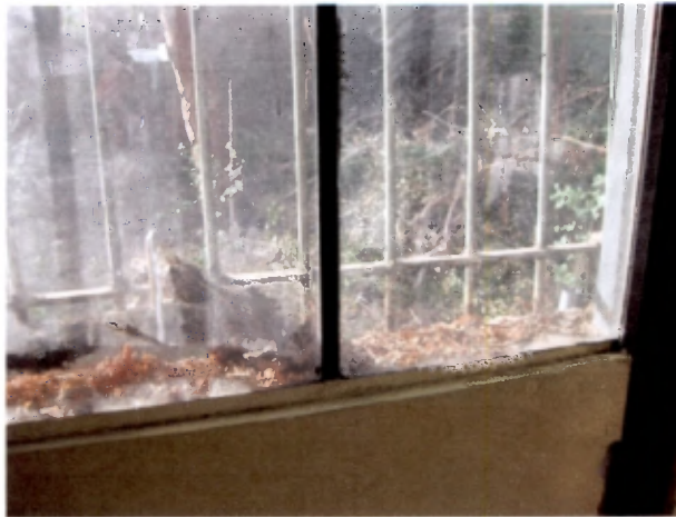
Ventana con acumulación de tierra y restos de hojas
