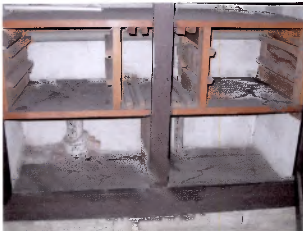
Falta de aseo; mobiliario inadecuado y en mal estado
