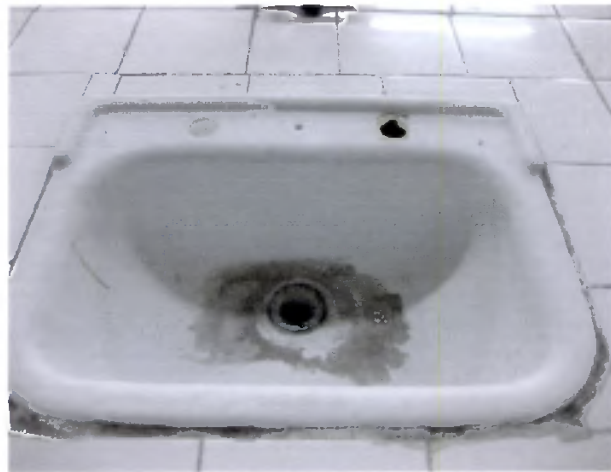
Lavamanos en malas condiciones
