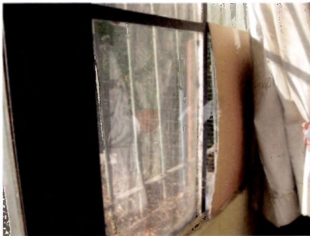
Ventana sin vidrio, cubierta con una pieza de cartón mal instalada
