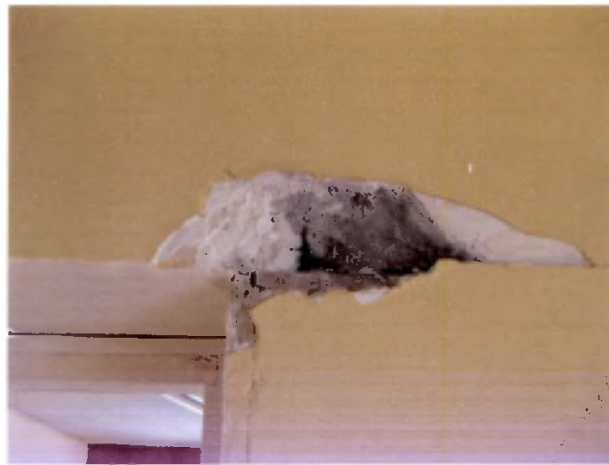
Marco de puerta dañado
