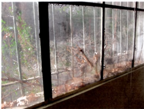
Ventana con acumulación de tierra y restos de hojas
