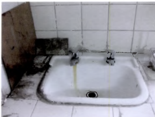
Lavamanos en malas condiciones
