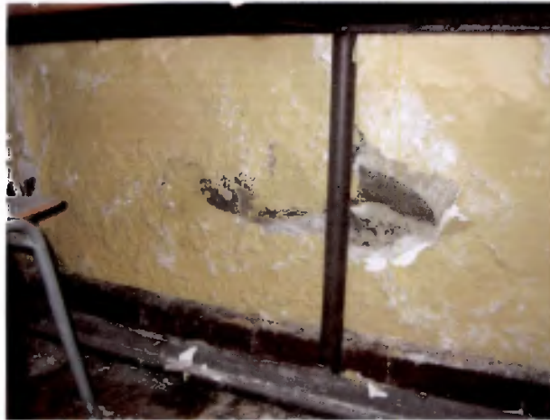
Filtraciones en la muralla
