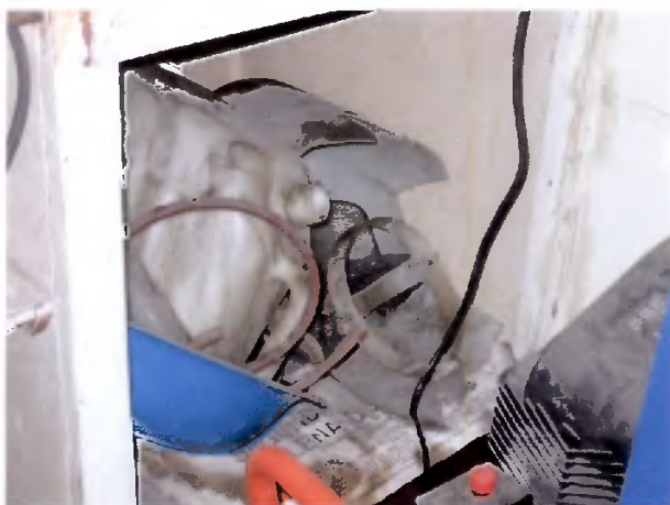
Mobiliario en mal estado; falta de aseo y orden
