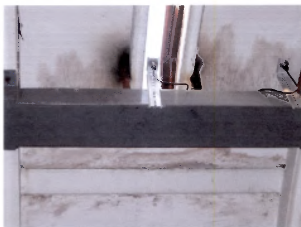
Evidencia de filtraciones
