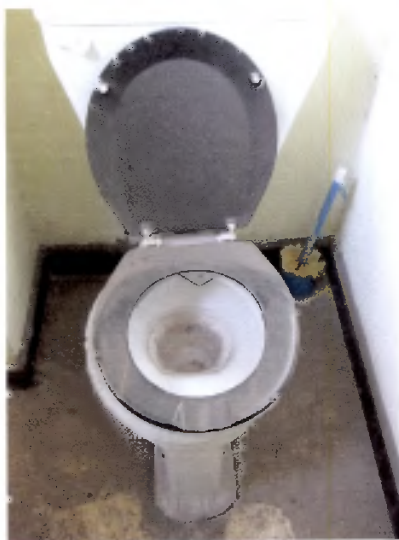
Baño en desuso, sin rastros de aseo y mantención
