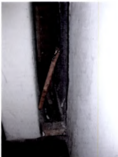
Falta de aseo
