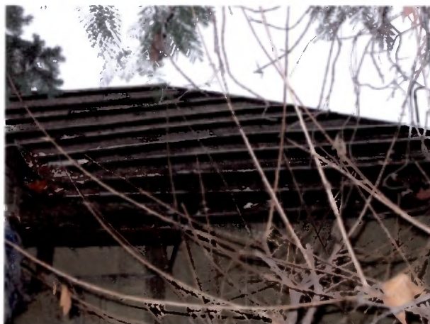
Daño en la techumbre
