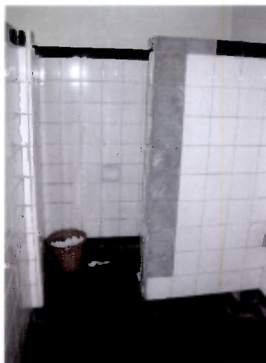
Muralla en mal estado
