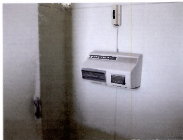
Artefacto en mal estado
