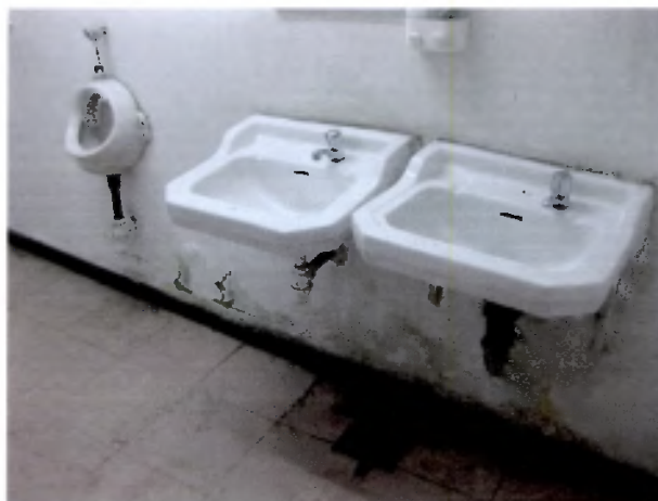
Paredes con filtraciones
