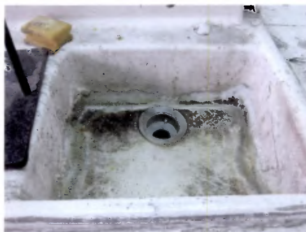
Lavatorio en malas condiciones
