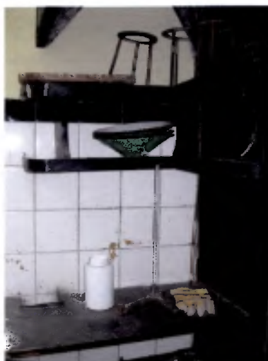
Falta de aseo
