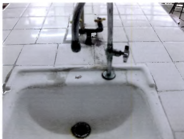
Lavamanos en malas condiciones
