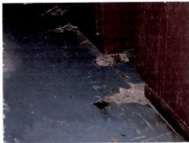
Piso flexit en mal estado
