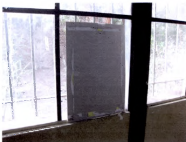
Ventana sin vidrio, cubierta con una pieza de cartón
