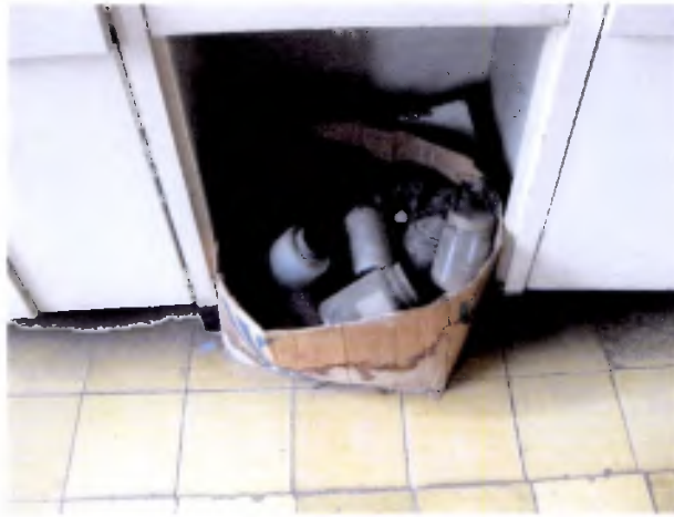
Falta de aseo
