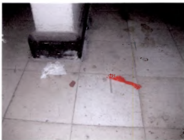
Falta de aseo
