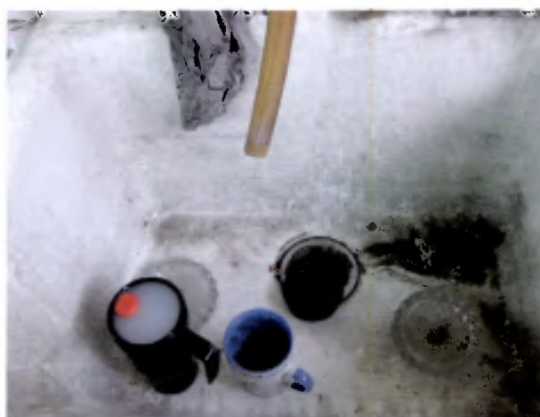
Lavatorio en malas condiciones
