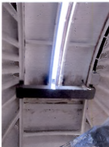
Evidencia de filtraciones
