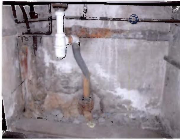
Instalaciones en malas condiciones
