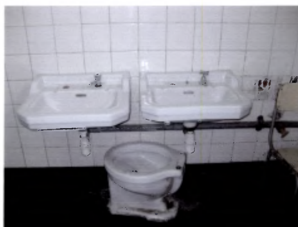
Inodoro en desuso
