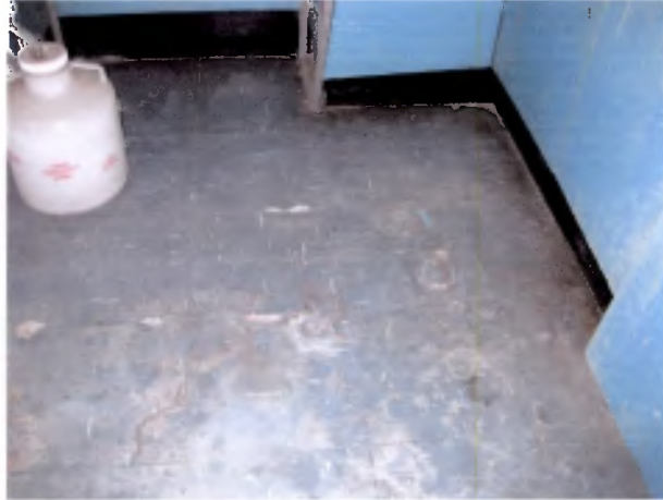
Piso flexit en mal estado
