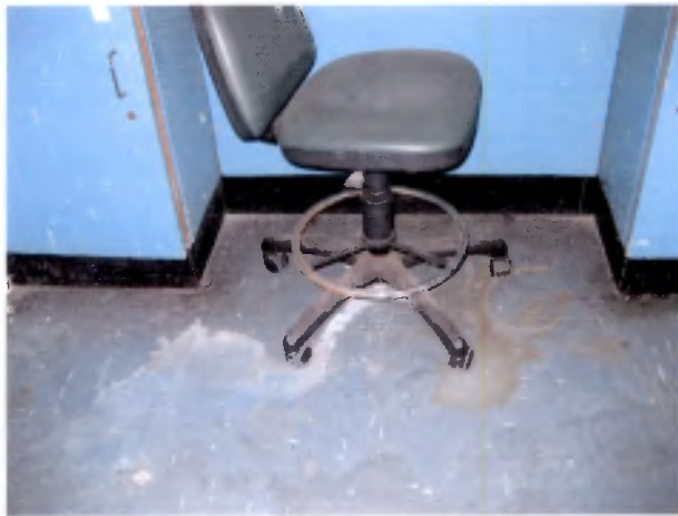
Piso flexit en mal estado
