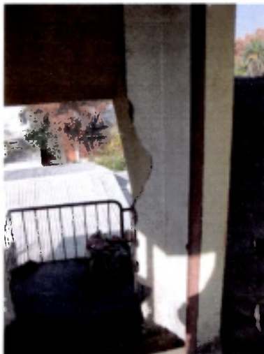
Base de copa de agua dañada
