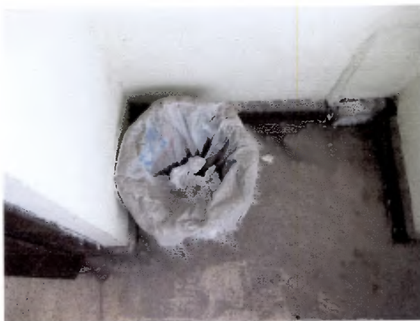
Baño en desuso, sin rastros de aseo y mantención
