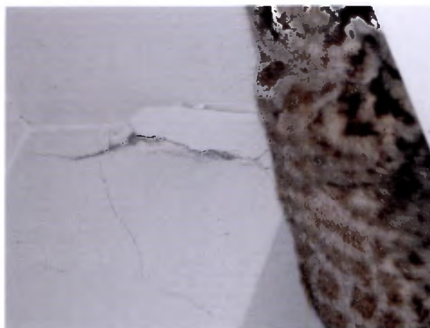
Daños producto del terremoto año 2010
