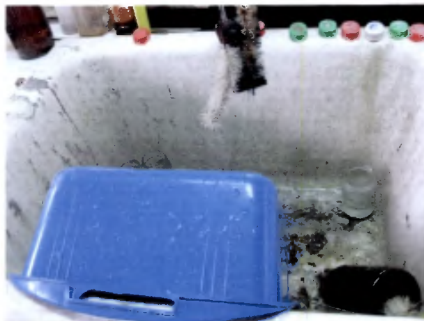
Lavatorio en mal estado
