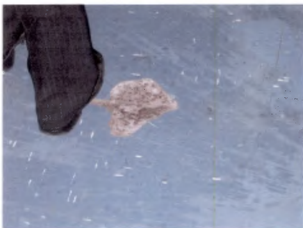
Piso flexit en mal estado
