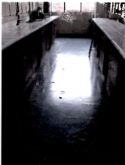
Piso flexit en mal estado
