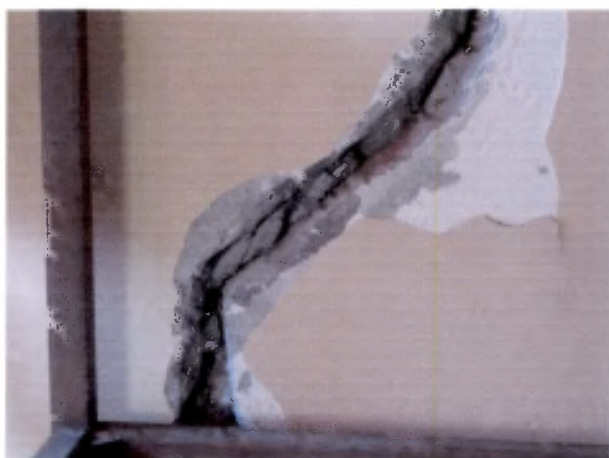
Grieta de importancia
