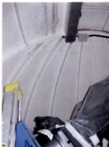
Evidencia de filtraciones
