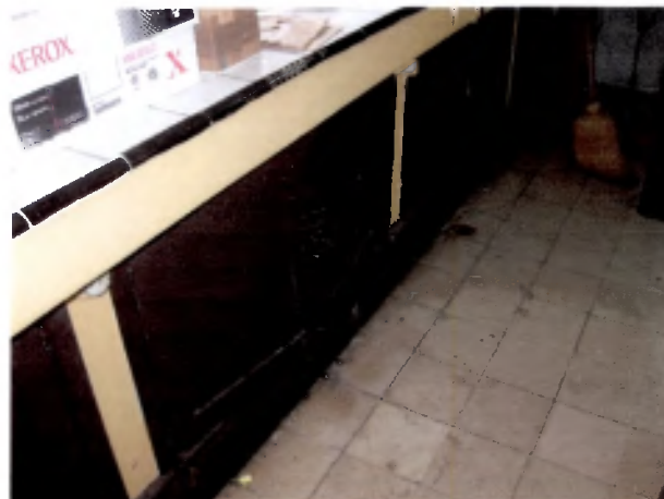
Mobiliario inadecuado y en malas condiciones
