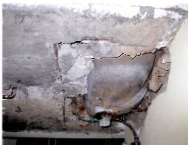
Lavamanos sin desagüe
