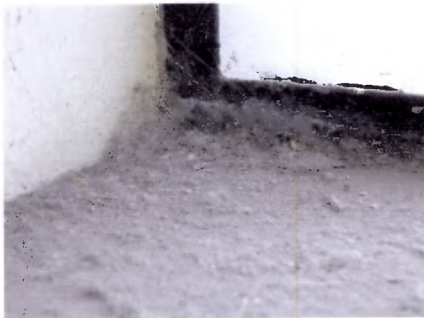
Ventana con acumulación importante de tierra
