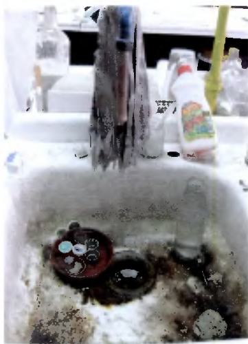
Lavatorio en muy malas condiciones, falta de aseo
