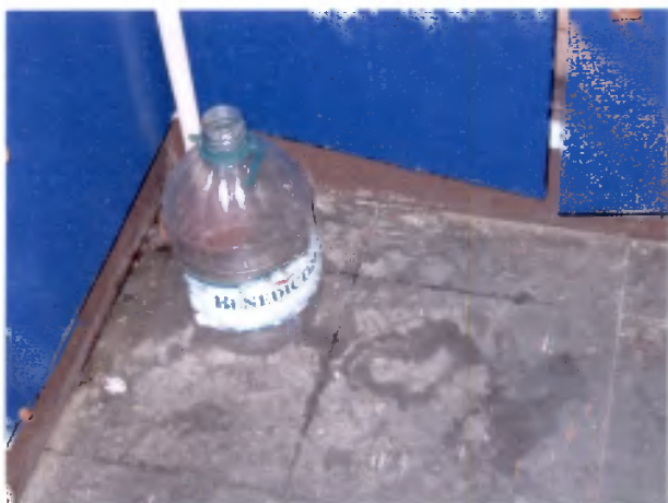
Piso en mal estado
