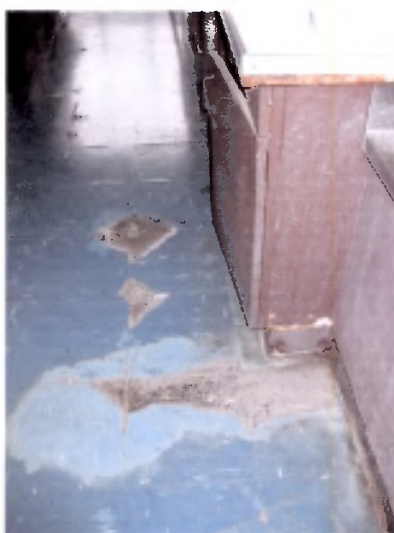
Piso flexit en mal estado
