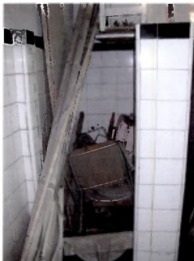
Baño en mal estado utilizado para acumular materiales en desuso
