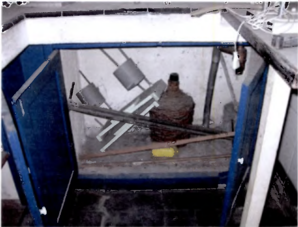
Falta de orden y aseo, mobiliario inadecuado y en mal estado
