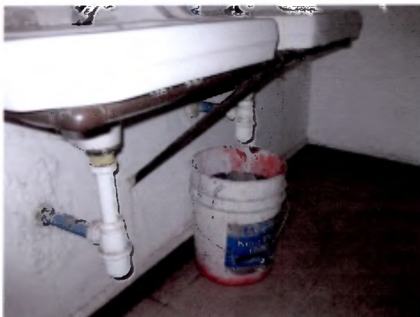
Lavamanos con filtraciones
