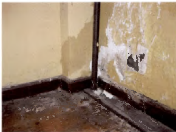
Filtraciones en la muralla
