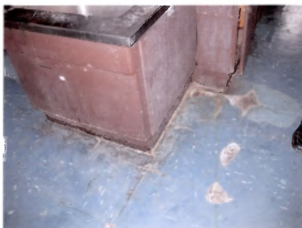
Piso flexit en mal estado
