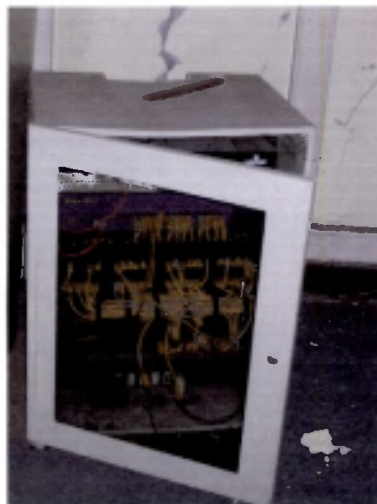
Switch en funcionamiento al interior de una de las dependencias del edificio
