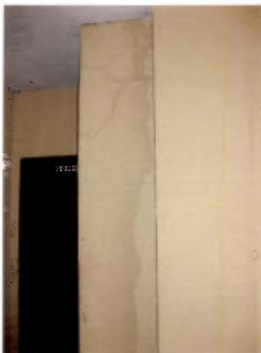
Muralla con daños producto de filtraciones y grietas
