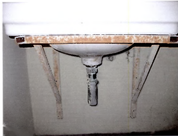
Soporte de lavamanos oxidado
