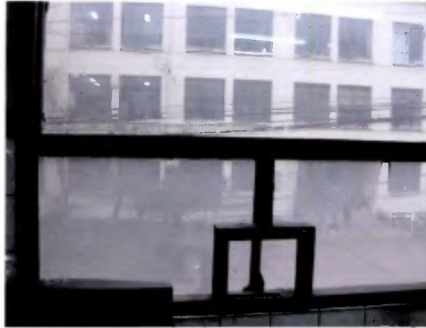
Falta de aseo (acumulación de tierra)
