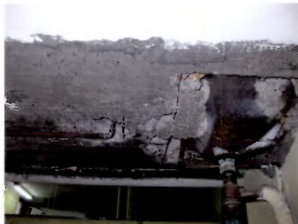
Instalaciones en malas condiciones
