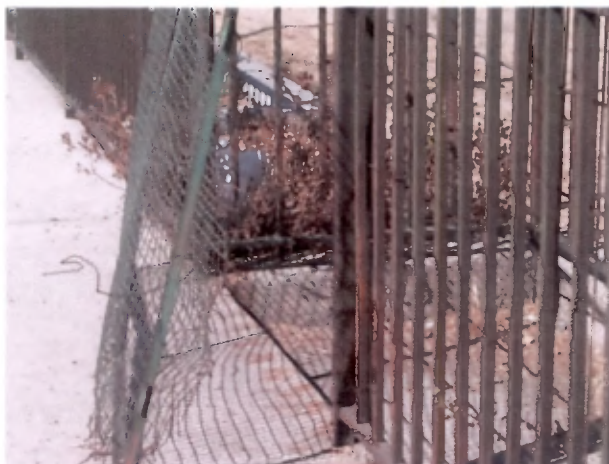
Cerco de la piscina deteriorado
