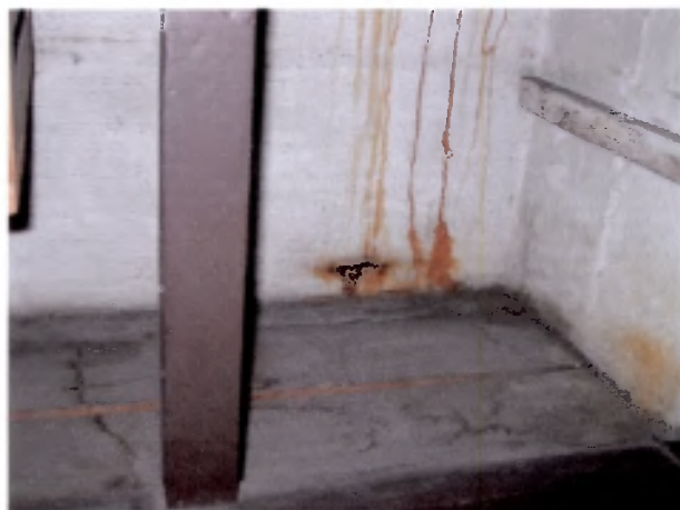
Instalaciones en malas condiciones
