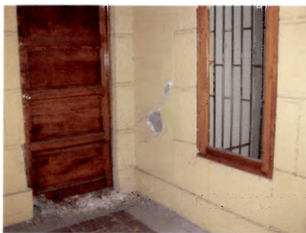
Daño importante en la fachada
