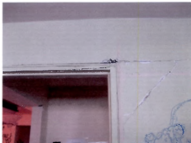
Marco de puerta dañado
