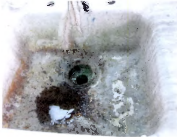
Lavatorio en muy malas condiciones, falta de aseo
