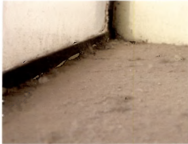
Falta de aseo, acumulación importante de aseo
