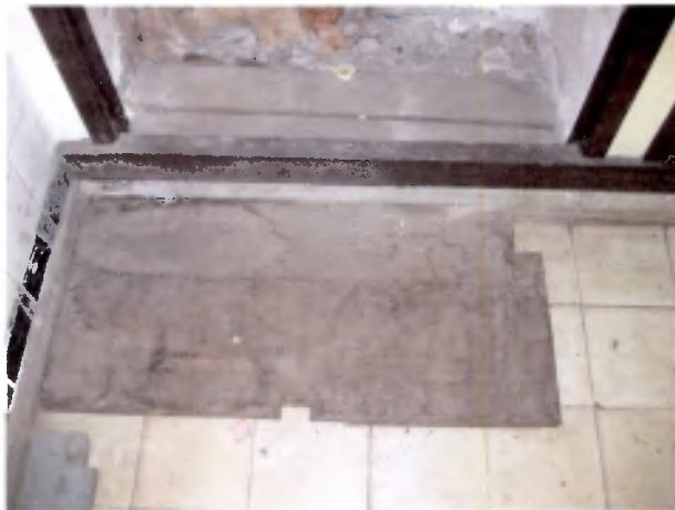
Instalaciones en malas condiciones
