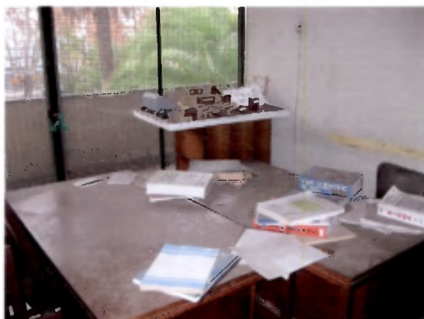
Oficina inutilizable, sin evidencia de intervención de trabajos de limpieza y despeje
